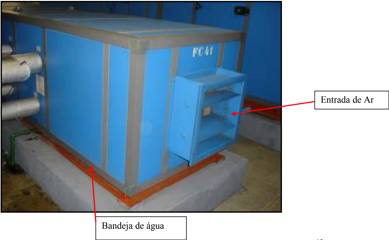
Figura 7: Sistema de ar condicionado localizado no Hospital 2 (HO-2)
