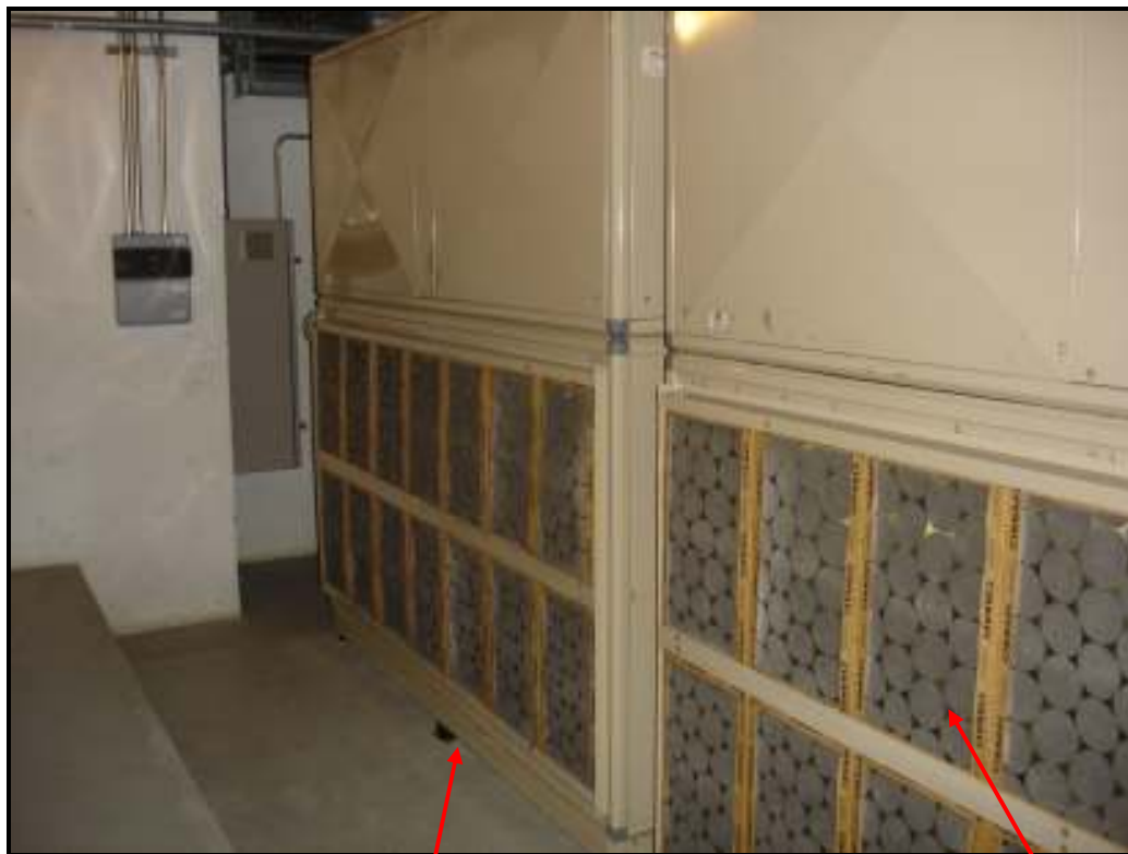
Figura 3: Sistema de ar condicionado localizado no Centro comercial (CC)
