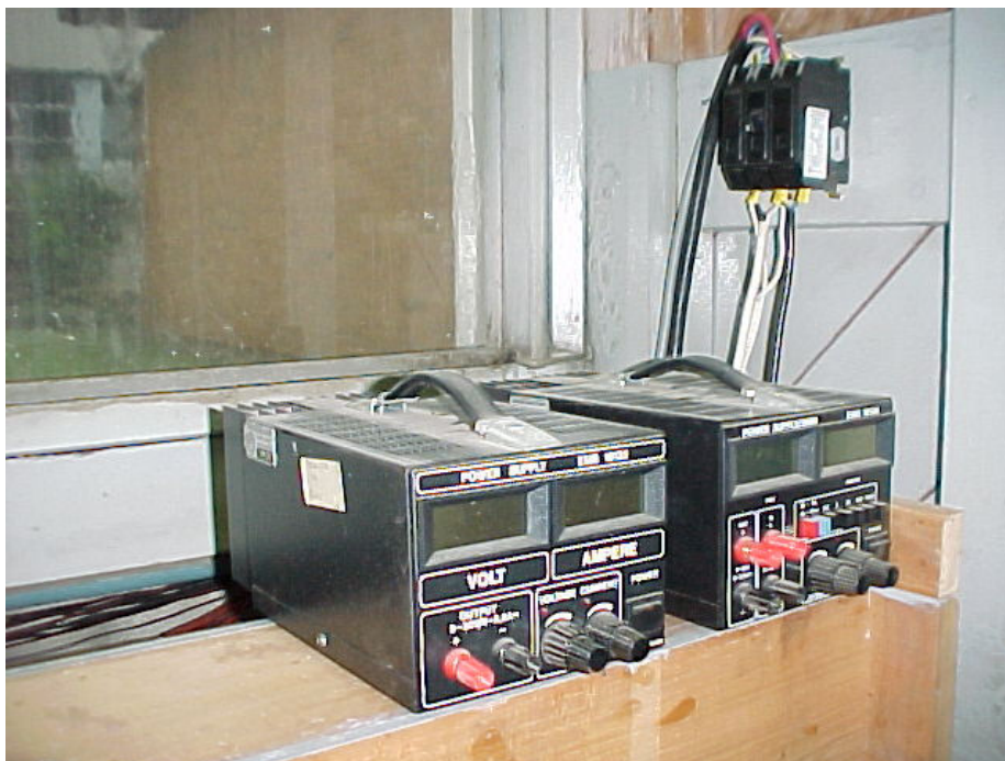
Figura 10 - Ponto de força e fontes de alimentação
