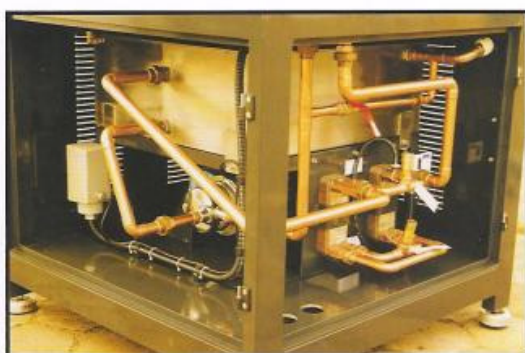
Sistema de refrigeração água/água com água deionizada.
