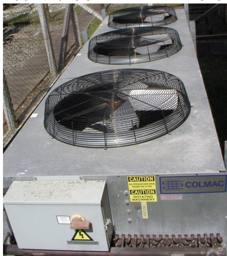
FIGURA 10. SISTEMA DE VENTILAÇÃO.
