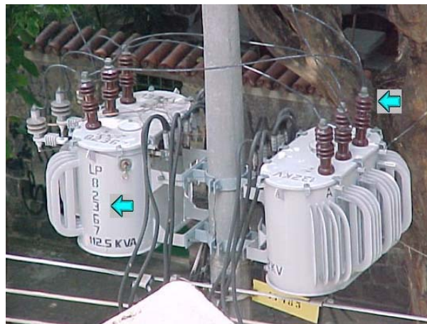
Figura 1.9 – Transformador semelhante ao utilizado no projeto .
