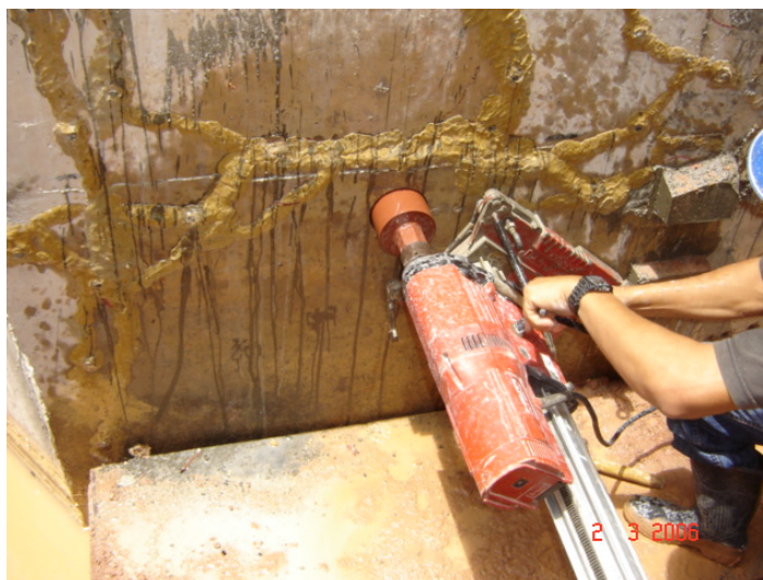
Figura 5.26 – Retirada de testemunho 150mm abaixo da trinca principal.
