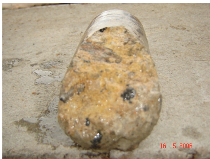
Figura 5.30 – Indicação do final da trinca através do testemunho extraído.
