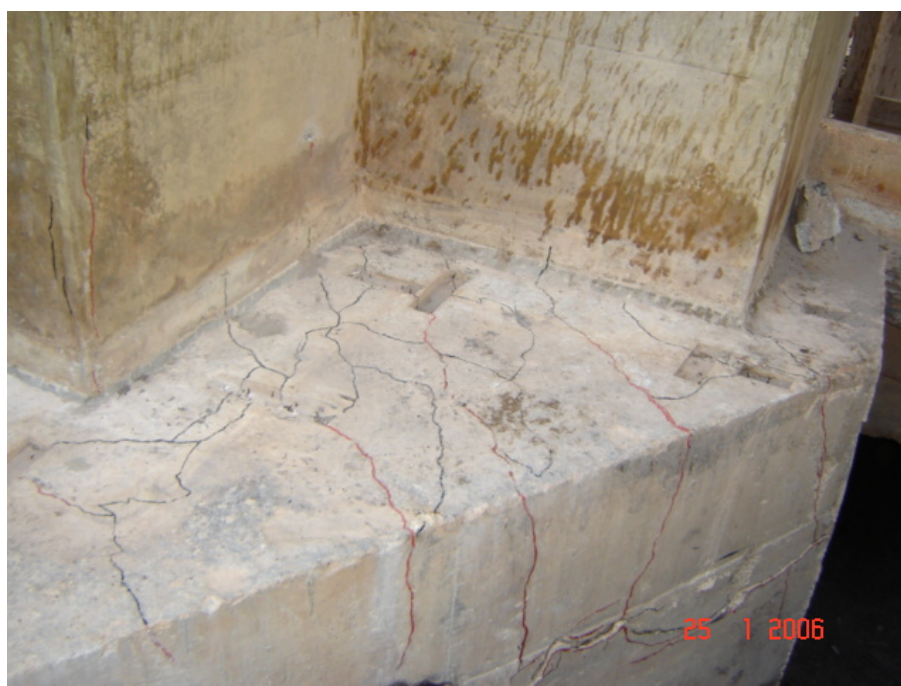
Figura 4.1 – Bloco de fundação com fissuras em forma de mapa. Obs: Para melhor visualização das fissuras, estas foram contornadas com lápis de cera.
