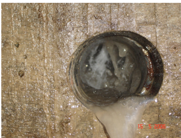
Figura 5.40 – Saída d'água após um período de lavagem das trincas.
