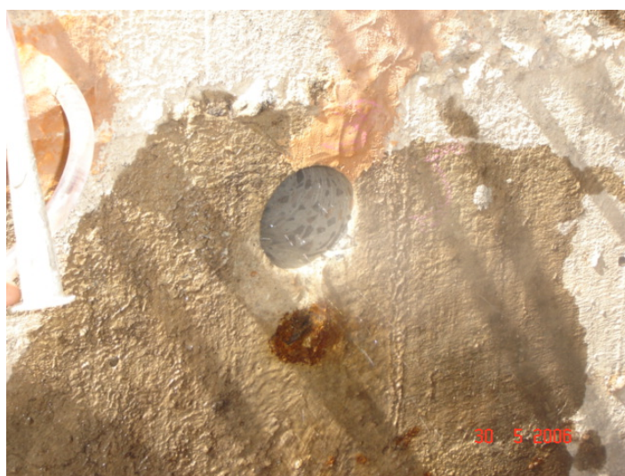
Figura 5.45 – Saída de água retida nas trincas pela força do ar injetado.
