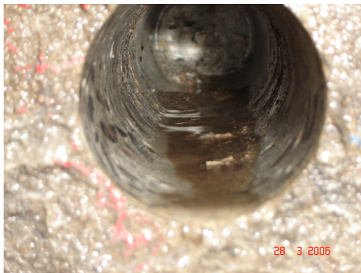
Figura 5.41 – Areia depositada proveniente do interior das trincas.
