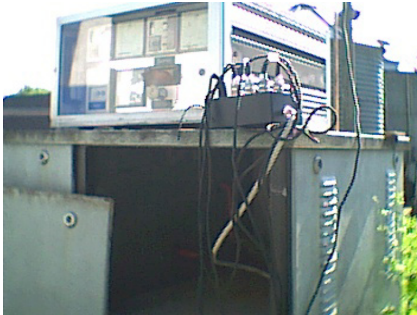
Figura 4.13 - Controle de vazão e caixa de conexões para os sensores de temperatura, radiação solar e velocidade do vento.
