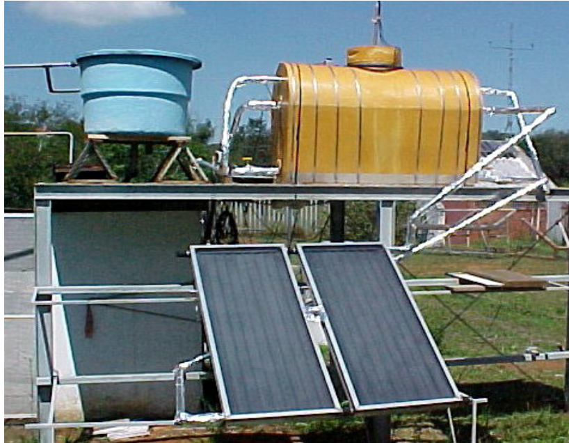
Figura 3.3 - Vista geral do sistema de aquecimento de água com reservatório horizontal.
