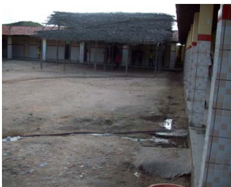
Foto 05- Pátio da escola – esgoto exposto no interior da escola.
