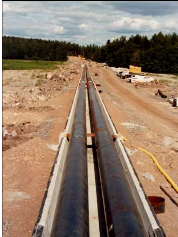
Figura 89 – Tubulação de uma instalação de aquecimento distrital em Mussalo Kotka – Finlândia.
