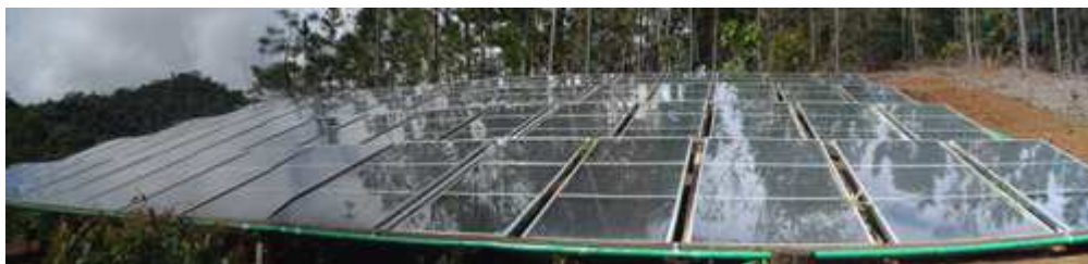
Figura 13 – Visão panorâmica baterias de coletores solares. Retiro Maanaim, ES.
