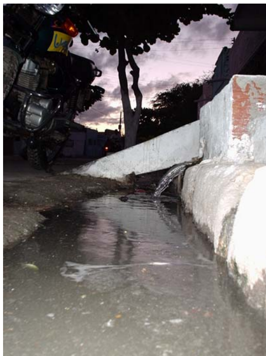
Figura 55 – Vista mostrando a água servida sendo despejada na via pública. Fonte: Arquivo pessoal, 2004.
