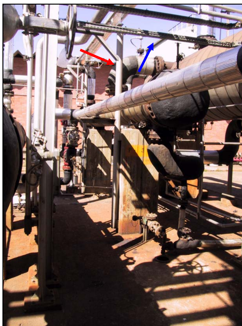
Figura 8-1 – Elementos estruturais a serem protegidos: coluna de seção circular (seta vermelha) e bandeja de cabos com seção retangular (seta azul)
