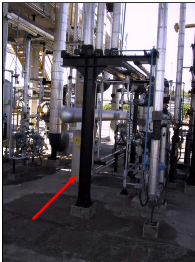
Figura 8-2 – Elemento estrutural a ser protegido: coluna de seção em I (seta vermelha)
