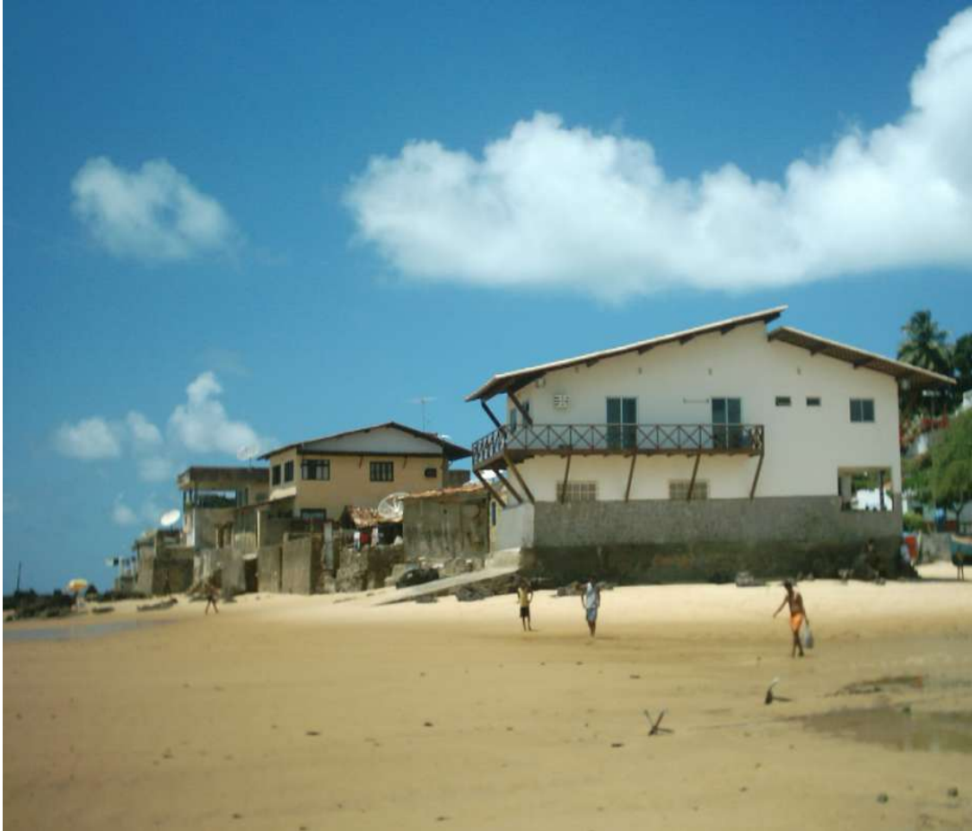
FIGURA 33: Vista dos fundos da Praça da Conceição, na praia do Porto. Observe os muros de arrimo construídos para combater os efeitos da erosão provocada pelo avanço do mar.
