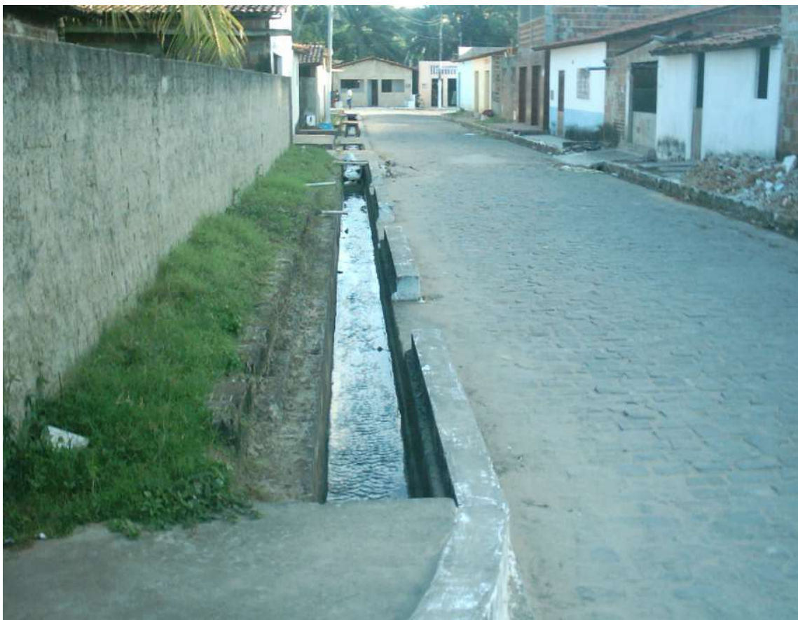
FIGURA 18: Vista de uma rua da cidade onde se pode observar o esgoto correndo em uma canaleta a céu aberto. Essa canaleta se interliga a outras que confluem para uma galeria feita pela Prefeitura que deságua na Praia do Porto.
