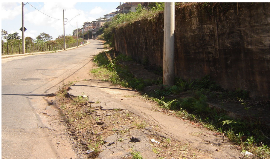
Figura 5.9 – Movimento de massas, deslocando o muro de contenção, destruindo trecho da rodovia
