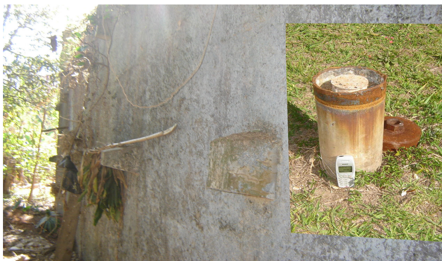
Figura 4.3 – Muro atirantado no fundo da Igreja São Francisco de Assis, para contenção do terreno abalado nos eventos chuvosos de 1979 e equipamento de monitoramento no local.
