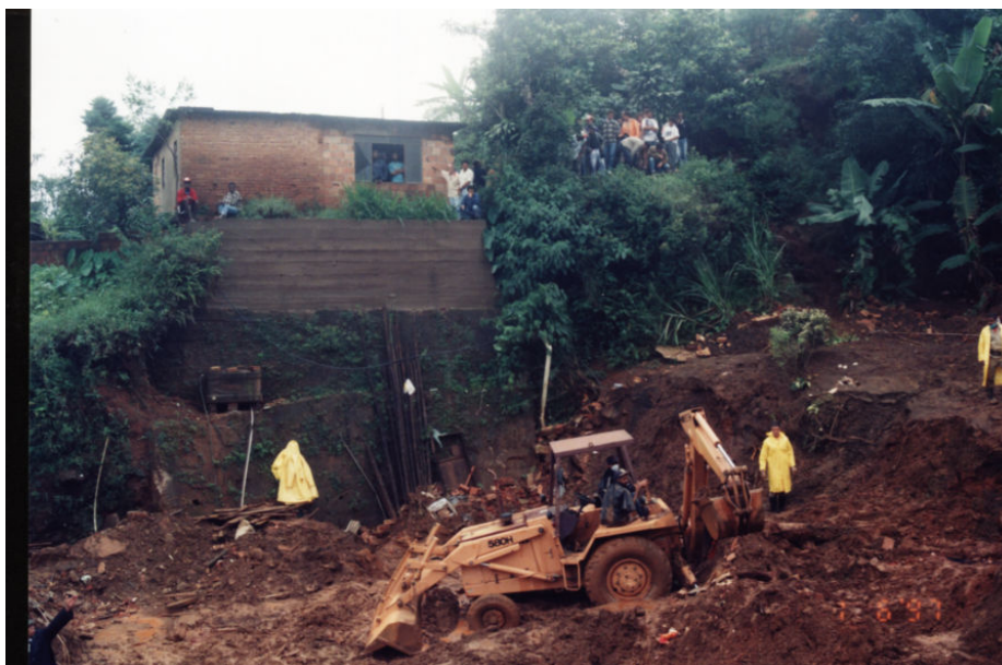
Figura 5.7 – Escorregamento favorecido pela ocupação inadequada do terreno, com vítimas fatais, observar a mesma situação da casa adjacente
