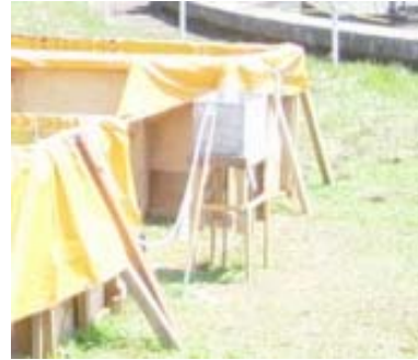
Figura 4.9b: Caixa de passagem 2 sem utilização de registros na entrada para regulação da vazão
