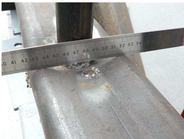
Figura 4.21 – Afundamento do montante na face superior do banzo no protótipo T02.
