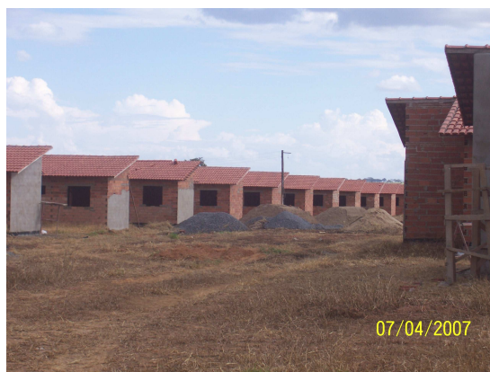
Figura 4.4: Conjunto habitacional Associação Habitacional Morar Bem, em Goiânia (GO), financiado com o Fundo de Desenvolvimento Social
