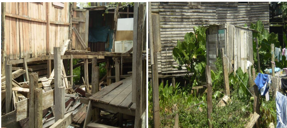
Figura 10: Fotos de casa e banheiro com fossa a céu aberto de um dos moradores Fonte: Fotos tiradas pela Pesquisadora na pesquisa de campo.
