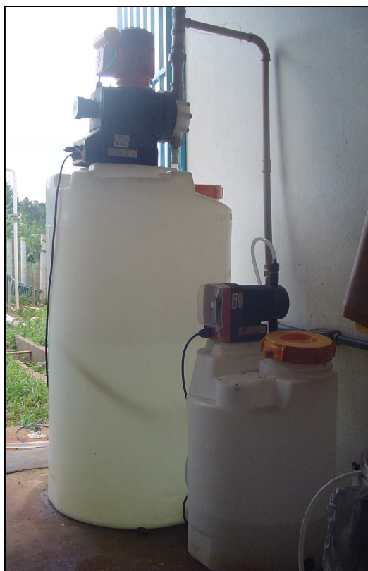
Figura 4.8 - Vista das bombas dosadoras instaladas sobre os tanques de armazenamento de coagulantes.
