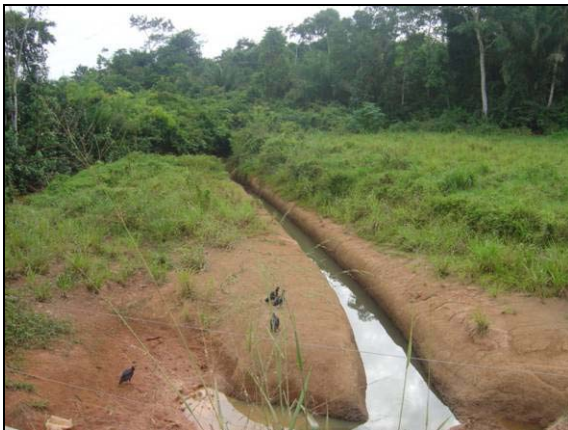
Foto 19 – Jusante da travessia a BR 364. Canal estreito e com marca de enchente.
