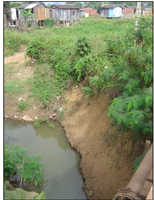
Foto 2 – Área de inundação com solo exposto. Resíduos depositados junto às margens.
