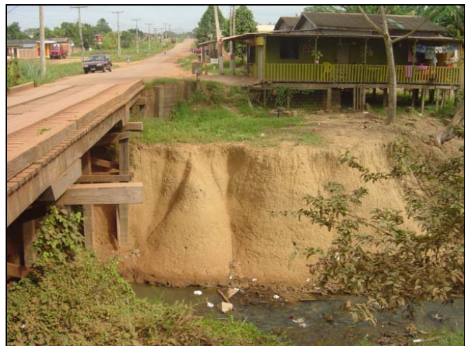
Foto 4 – Margem sem vegetação mostra estabilidade às cheias. Rejeitos lançados no leito.
