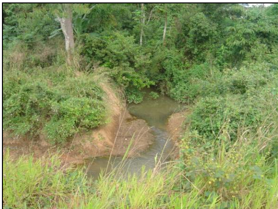
Foto 21 – Montante da BR 364. Represamento. Problemas frequentes de rompimento do bueiro da travessia.
