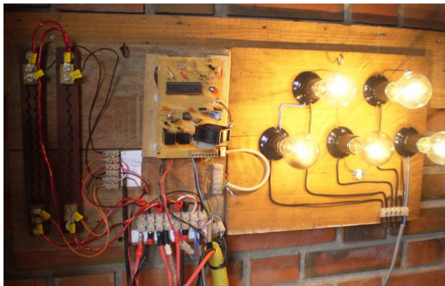
Figura 5.15 Placa de controle do sistema e carga com conjunto de lâmpadas.
