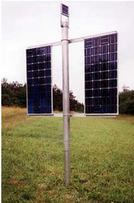
(a) Instalado em campo
