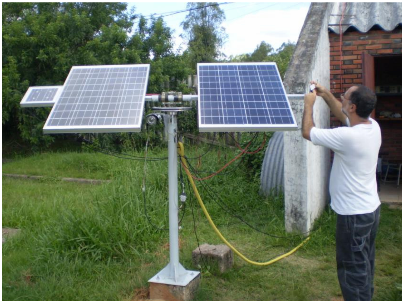
Figura 5.11 Seguidor solar com módulos e sensores instalados.
