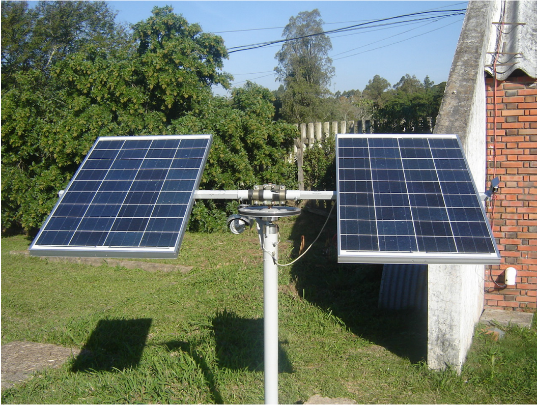
Figura 5.12 Seguidor solar com módulos instalados
