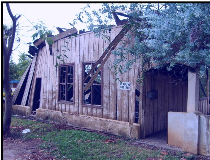
Fotografia 3.12 - Um dos escritórios do Lloyd Paranaense destruído em incêndio. São Mateus do Sul (PR)
