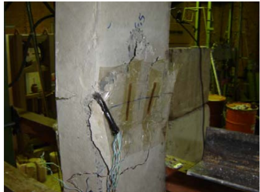
Figura 4.5 – Ruptura do pilar PFN15-3
