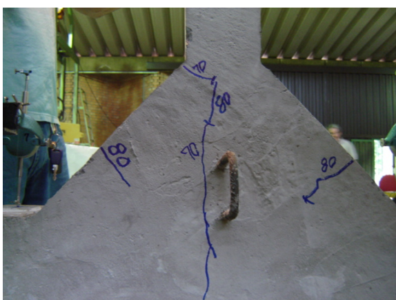
Figura 4.2 – Fissura no pilar PFN0-3
