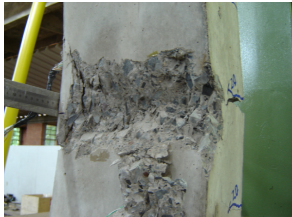
Figura 4.7 – Ruptura do pilar PFN30-3
