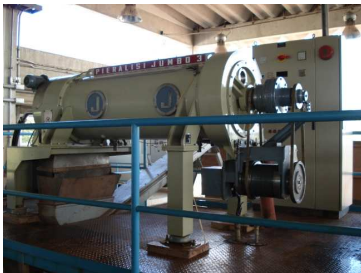
Figura 4.5 – Centrífuga da unidade de desidratação de lodo da ETA-Descoberto
