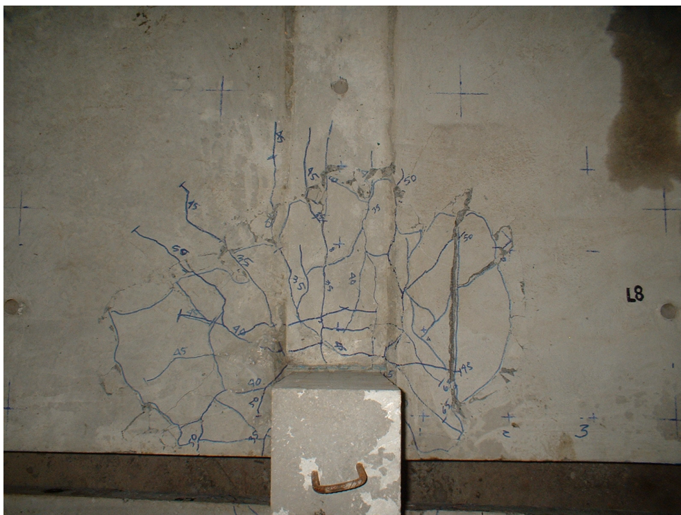
Figura 4.39 – Ruptura da laje do modelo L8.
