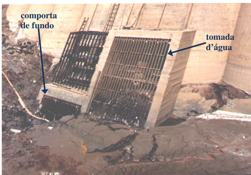
FIGURA 09 – Vista das Grades de Tomada d'água e da Comporta de Fundo do Reservatório de Cariobinha (Convênio CPFL/UNICAMP Coiado, 2001)
