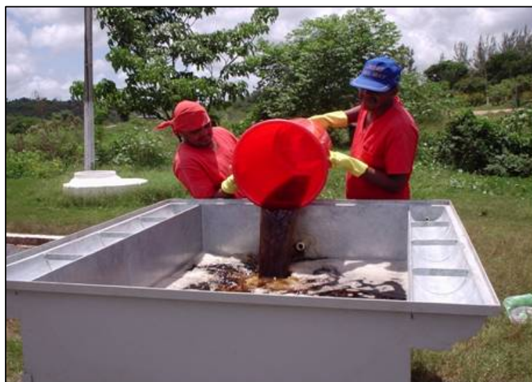
Figura 3.9: Preenchimento do Evaporador com lixiviado
