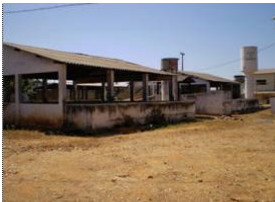
FIGURA 20: edificações muito antigas trazendo como consequência o acúmulo de águas pluviais.
