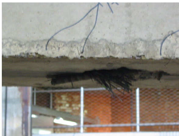
Figura 2.24 – Detalhe da ruptura da barra de CFRP na viga VC 2.2 (Castro et al, 2004)
