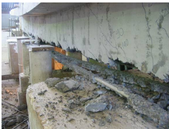
Figura 2.28 - Detalhe do descolamento das barras de GFRP na viga VA – RBG
