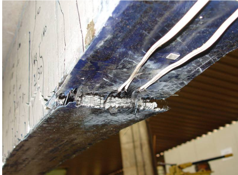
Figura 4.25 – Detalhe do compósito de CFRP na viga VA – RMC após a ruptura
