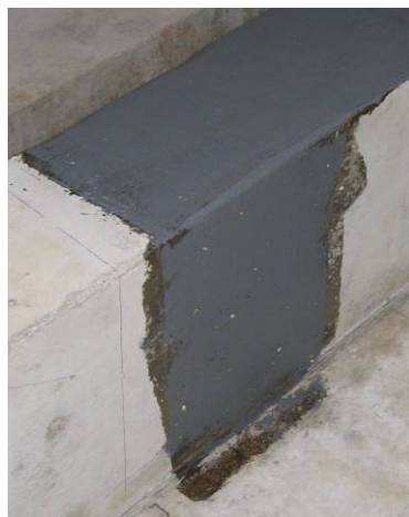
Figura 3.41 – Superfície com a argamassa epóxica FC
