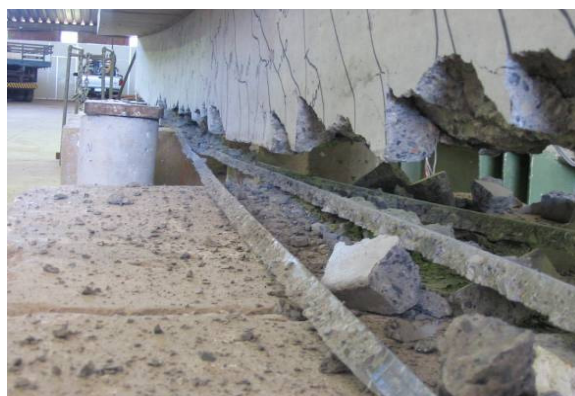
Figura 2.30 - Detalhe do descolamento das tiras de laminado de CFRP na VB – RLC
