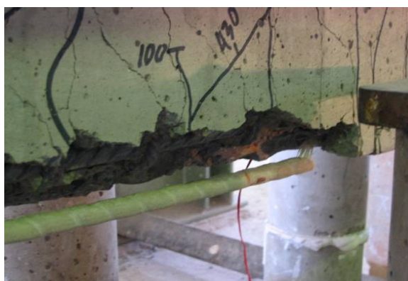
Figura 2.29 - Detalhe da ruptura da barra de GFRP da viga VB – RBG
