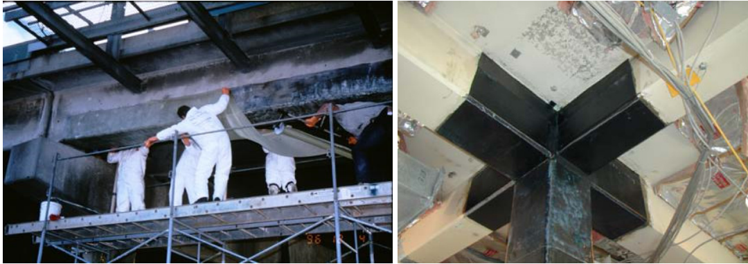
Figura 2.5 – Colagem externa de manta de fibra de carbono (FHWA, 2005 e D.S. Brown 2005)
