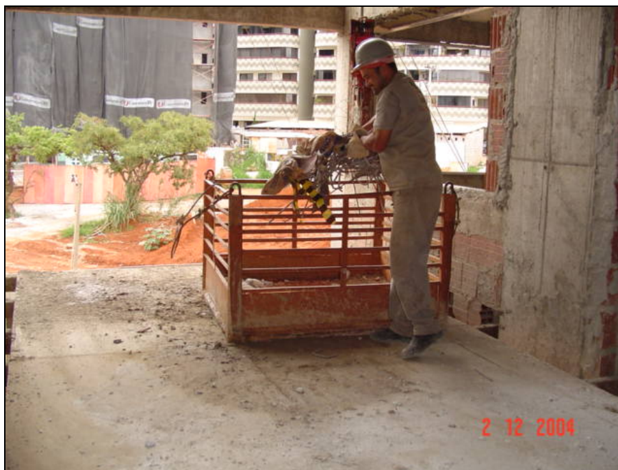
Fotografia 4.3 – Detalhe da gaiola metálica usada para coleta e transporte de RSCD no canteiro EC-1/CO-1.
