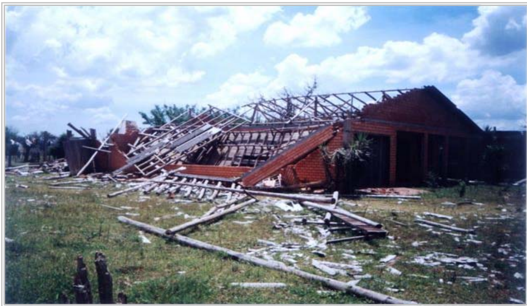
Figura 2.12 – Casa destruída pela tormenta- cidade de Viamão-RS
