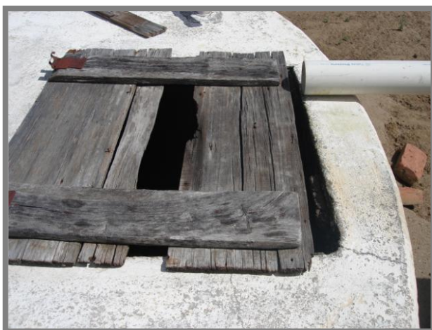
Figura 32 - Cisterna com tampa que favorece a entrada de impurezas
