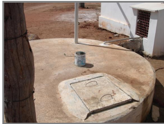
Figura 29 - Cisterna com sistema de bombeamento elétrico desativado
