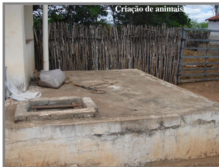
Figura 30 – Cisterna mal localizada
