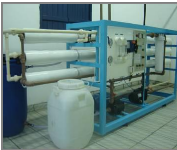
Figura 18 - Vista do dessalinizador instalado na Comunidade de Uruçu
