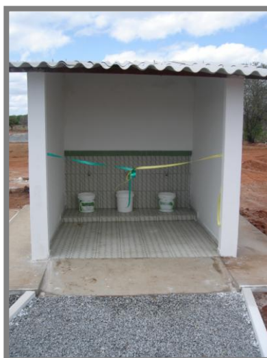
Figuras 35 - Vista do chafariz coletivo, solução alternativa de abastecimento de água potável na comunidade de Uruçu
