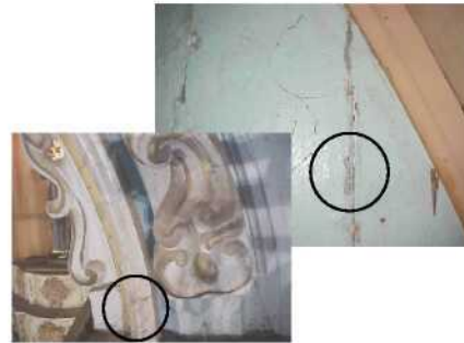
Sujidade e ataque de térmitas no coroamento
