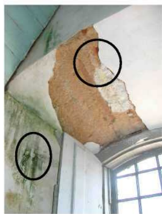
Ilustração 79 - Ataque microbiológico e perda do reboco. Foto da autora. 2005.
