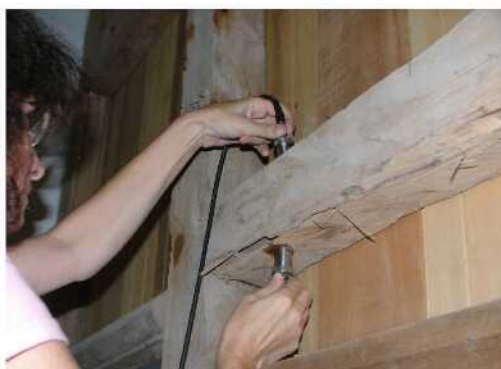
Ilustração 32 - Posicionamento dos transdutores na superfície para leitura no sentido transversal. Foto - Angela do Valle.
