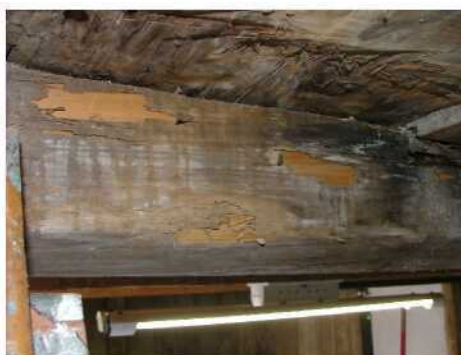
Ilustração 74 - Peça estrutural degradada. Foto da autora
