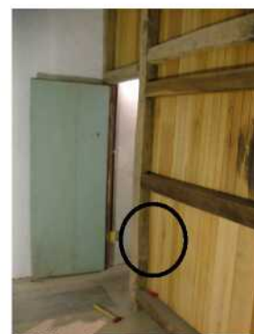
Ilustração - Estado de conservação do montante nº 2 Foto - Angela do Valle
