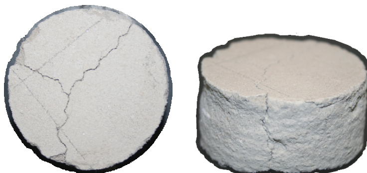
Figura 4.48 – Amostra extraída da região do revestimento com fissuras do corpo-de-prova SC.AME6.30_Sev.
