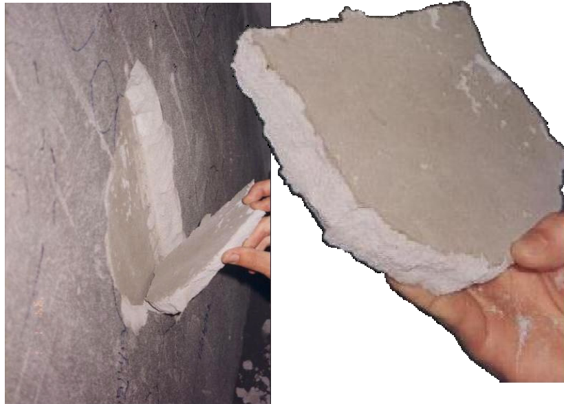
Figura 1.1 - Descolamento do revestimento em argamassa, em placas coesas, com ruptura na interface do chapisco com a estrutura de concreto (Bauer, 2002).
