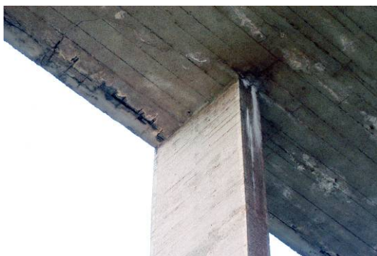
c) Laje de cobertura – fachada oeste Cobrimento - F_i = 3 Eflorescência - F_i = 3 Corrosão - F_i = 4 Manchas - F_i = 3
