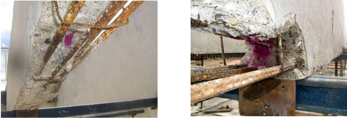
Figura 5.7 – Reação do indicador, fenolftaleína, realizadas nas vigas do pergolado, devidamente escoradas.
