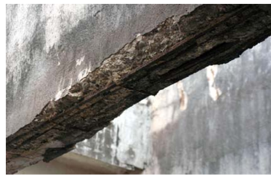
d) Viga da cobertura (pergolato) Corrosão - F_i = 4 Manchas - F_i = 4
