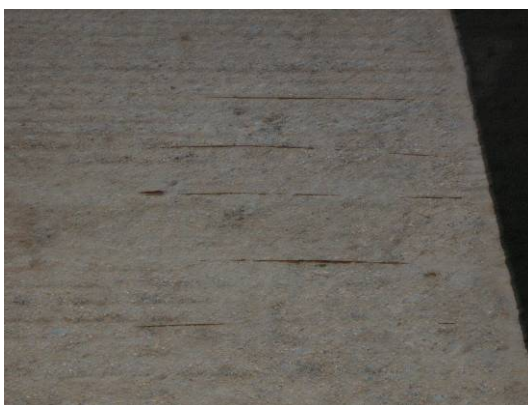
Figura 5.11 – Cobrimento deficiente em pilar de fachada do Palácio da Justiça
