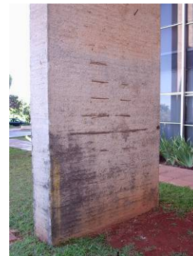
b) Pilar externo – fachada norte Cobrimento deficiente - F_i = 3 Manchas superficiais - F_i = 2
