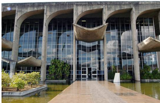
a) Fachada principal – Elem. arquitetônicos Manchas superficiais - F_i = 4
