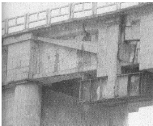
Figura 1. 5 - Região colapsada da ponte no Rio Grande do Sul (Cunha et al. , 1998).
