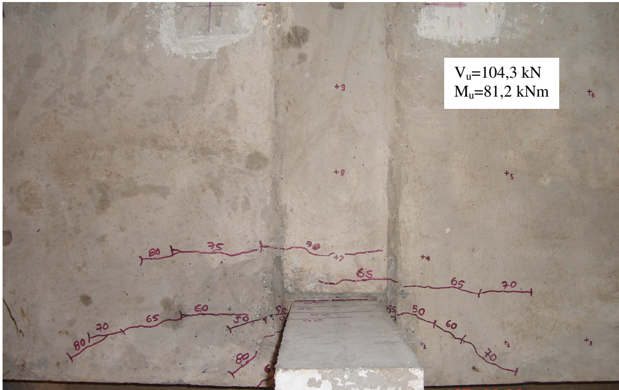
Figura 4.70 Ruptura da laje do modelo L15
