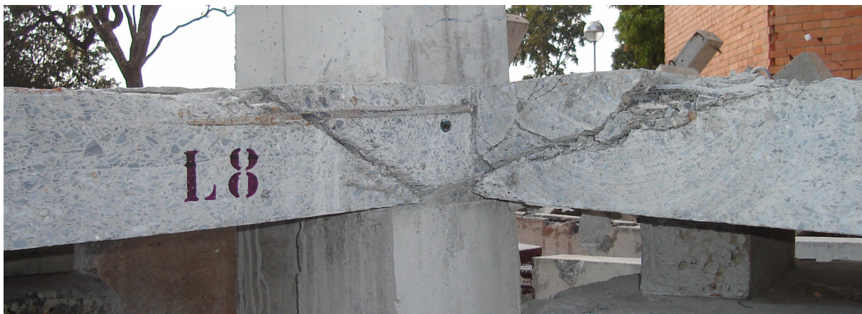
Figura 4.57 Seção transversal da ruptura laje L8
