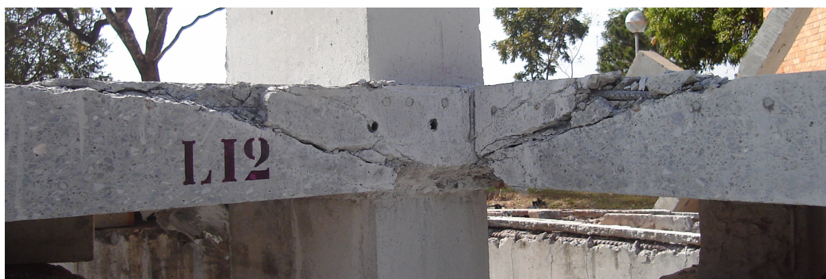
Figura 4.65 Seção transversal da ruptura laje L12
