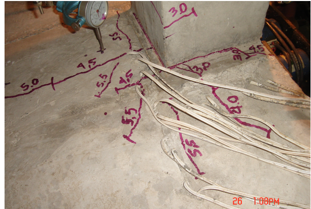
Primeiras fissuras L14
