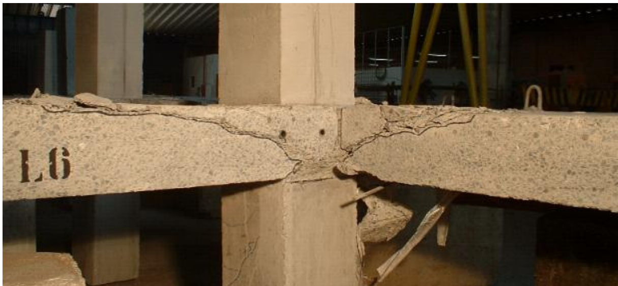
Figura 4.53 Seção transversal da ruptura laje L6
