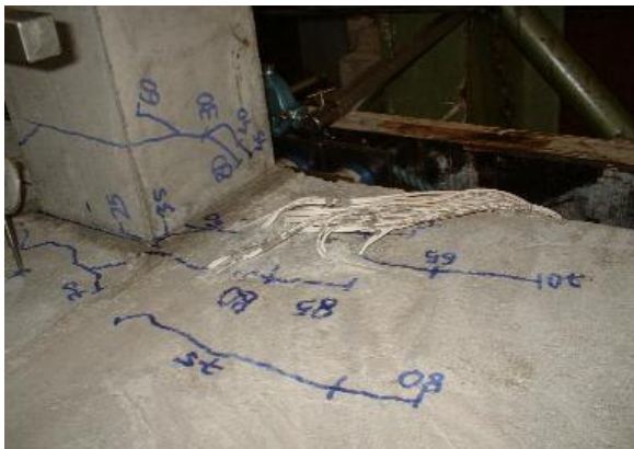
Primeiras fissuras: L7
