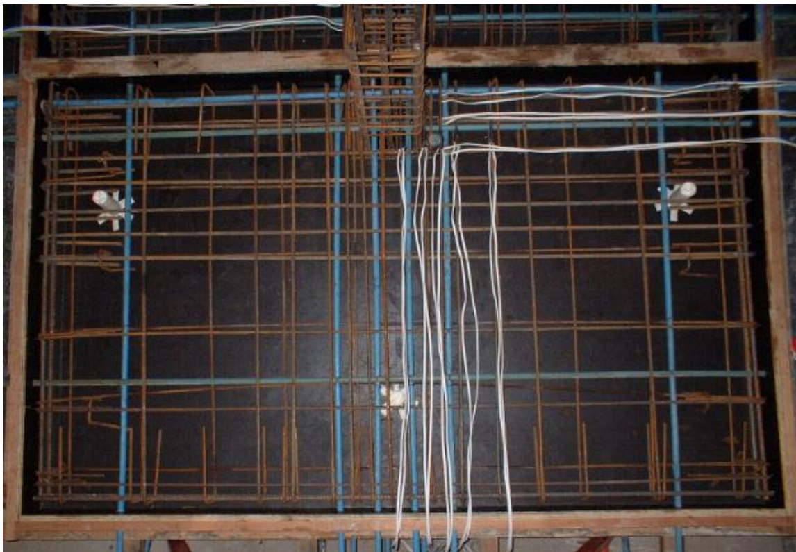
Figura 3.20 Fotografia da armadura da laje L11
