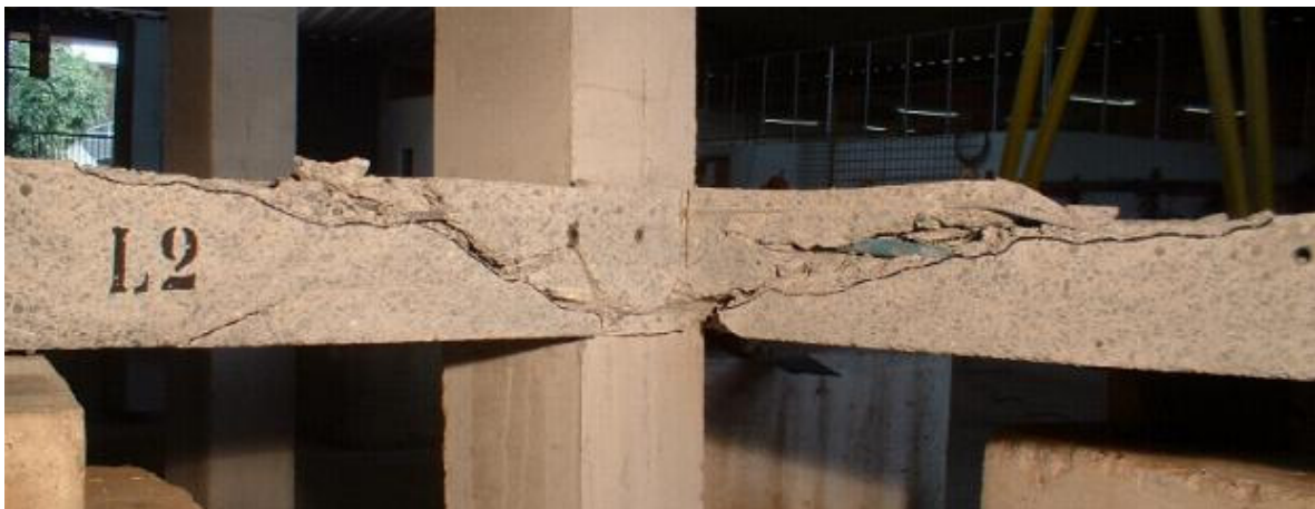
Figura 4.45 Seção transversal da ruptura laje L2
