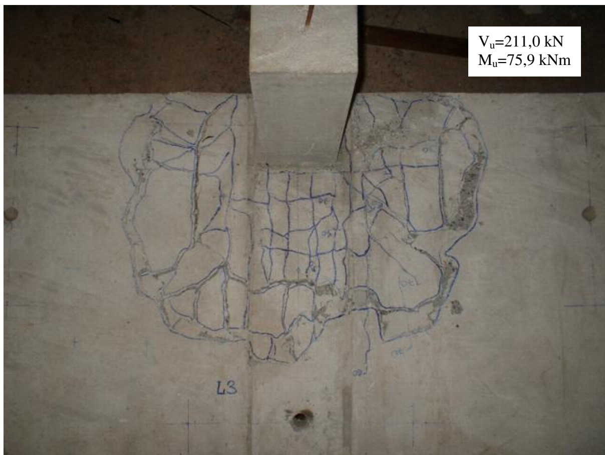
Figura 4.46 Ruptura da laje L3
