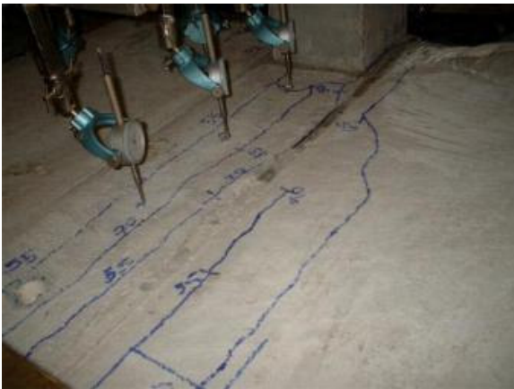
Primeiras fissuras: L1
