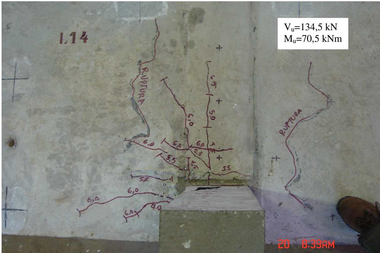
Figura 4.68 Ruptura da laje do modelo L14
