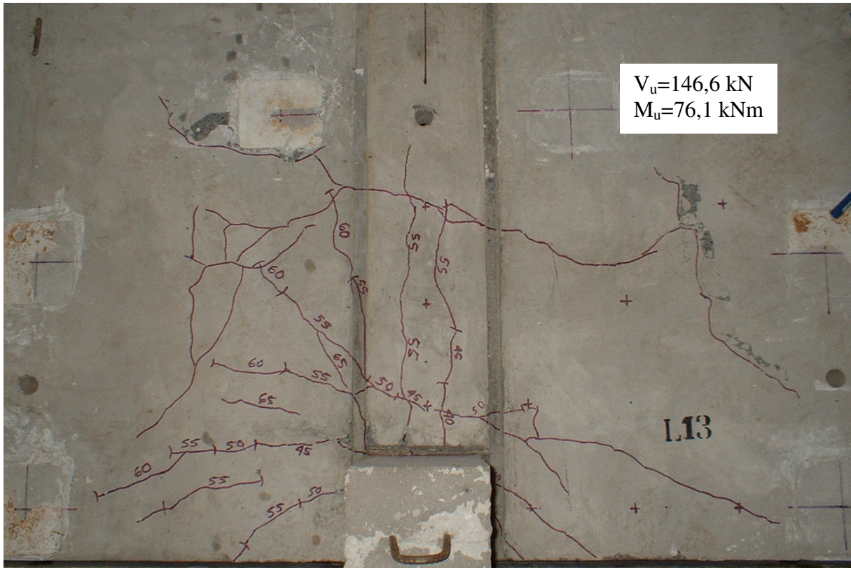
Figura 4.66 Ruptura da laje do modelo L13
