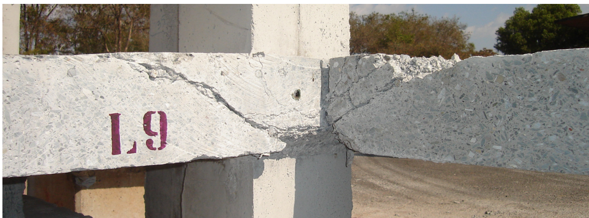
Figura 4.59 Seção transversal da ruptura laje L9
