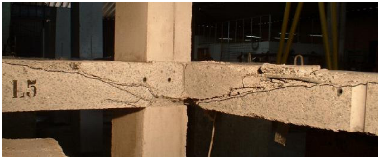
Figura 4.51 Seção transversal da ruptura laje L5
