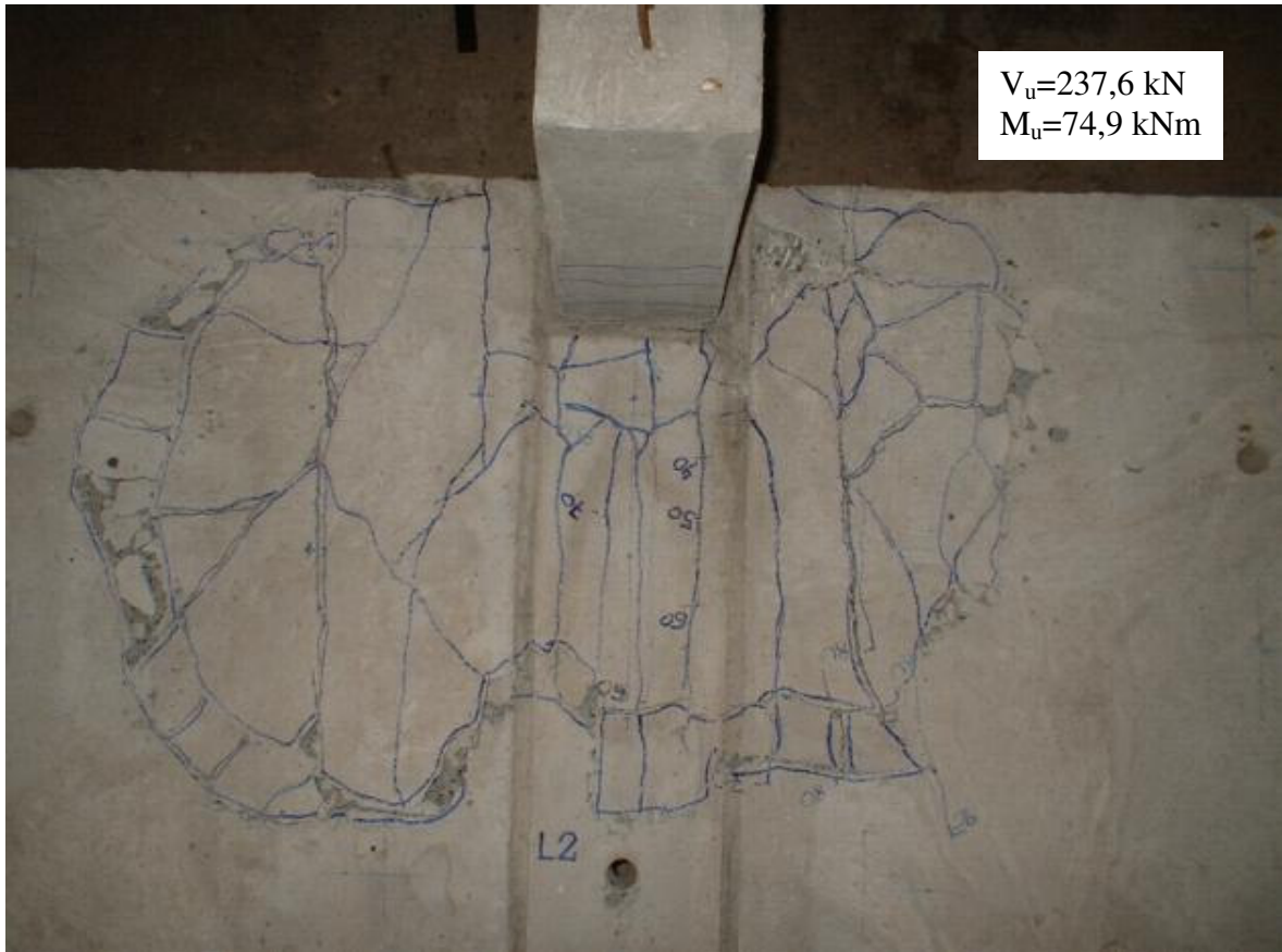
Figura 4.44 Ruptura da laje L2
