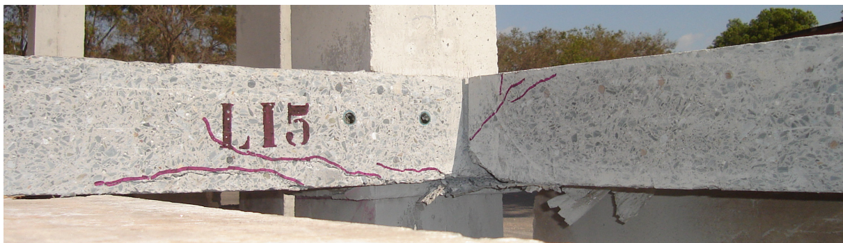
Figura 4.71 Seção transversal da ruptura laje L15
