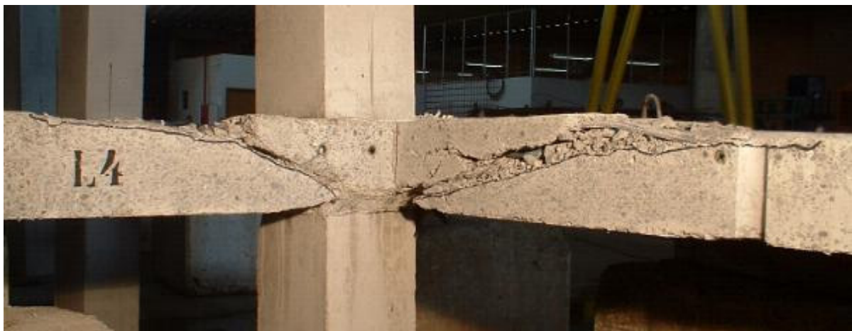
Figura 4.49 Seção transversal da ruptura laje L4
