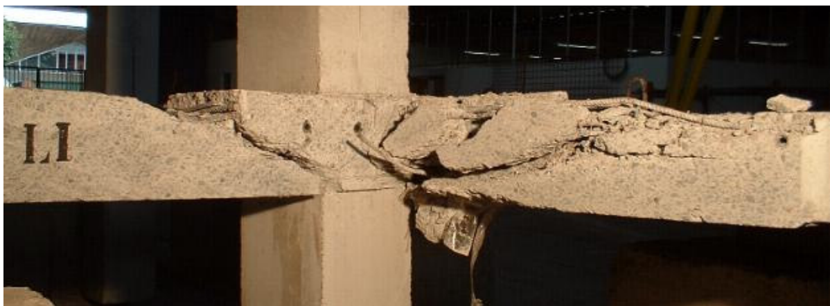
Figura 4.43 Seção transversal da ruptura laje L1
