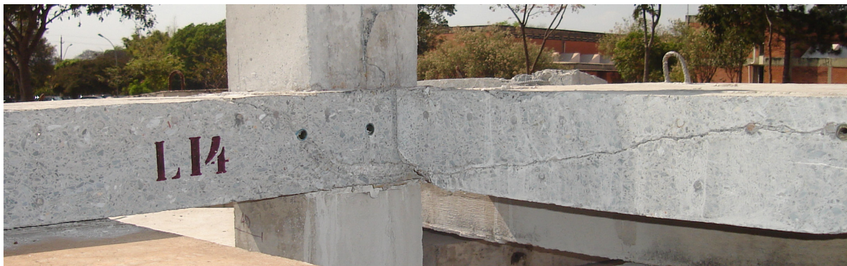
Figura 4.69 Seção transversal da ruptura laje L14
