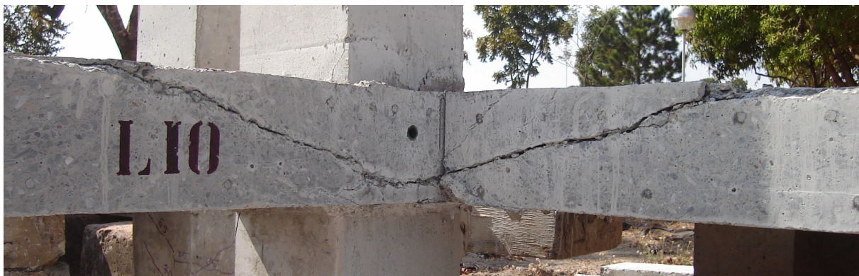
Figura 4.61 Seção transversal da ruptura laje L10
