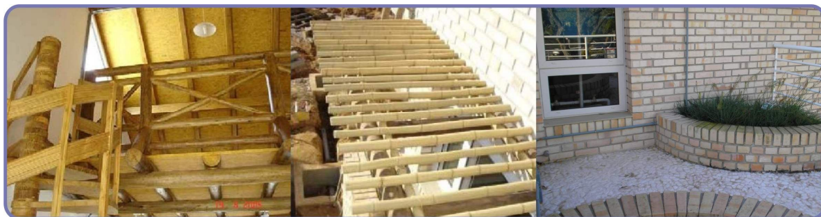
Figura 35: Detalhes da Casa Eficiente.
