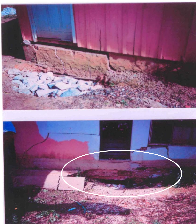
FIGURAS 2.20 e 2.21 – COLAPSO INDUZIDO PELA EXTRAÇÃO DE ÁGUA SUBTERRÂNEA FONTE: Mineropar (2005)
