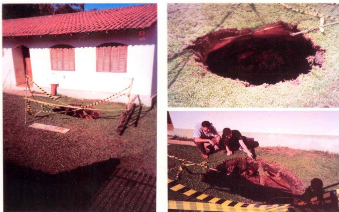
FIGURAS 2.8 2.9 – COLAPSO NATURAL DE SOLO (DOLINA) EM ÁREA CÂRSTICA COM DIMENSÕES 1,90 M X 1,50 M X 3,00 DE PROFUNDIDADE FONTE: Mineropar (2005)
