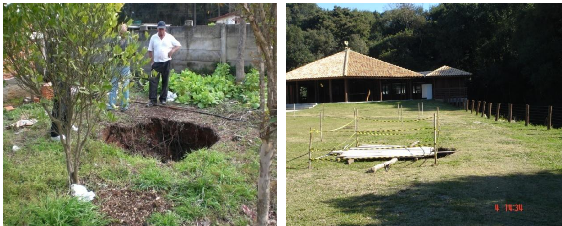
FIGURAS 2.6 E 2.7 – COLAPSO NATURAL DE SOLO (DOLINA) EM ÁREA CÂRSTICA DE ALMIRANTE TAMANDARÉ
