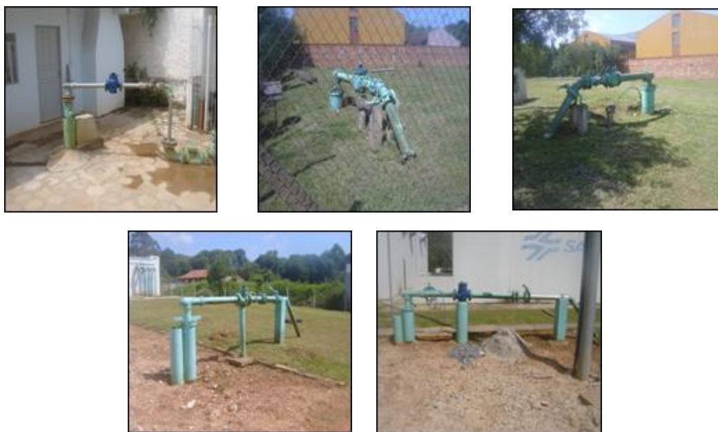
FIGURAS 3.16 A 3.20 – FOTOS DOS CINCO POÇOS DA SANEPAR SITUADOS NA SEDE DO MUNICÍPIO DE ALMIRANTE TAMANDARÉ
