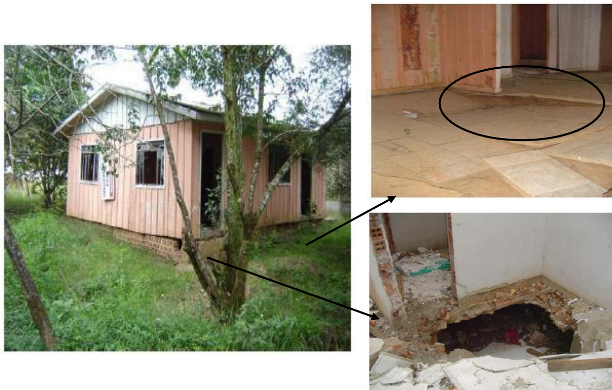
FIGURAS 2.14, 2.15 E 2.16 – RESIDÊNCIA INTERDITADA EM ÁREA CÂRSTICA DE ALMIRANTE TAMANDARÉ FONTE: Favetti (2006)
