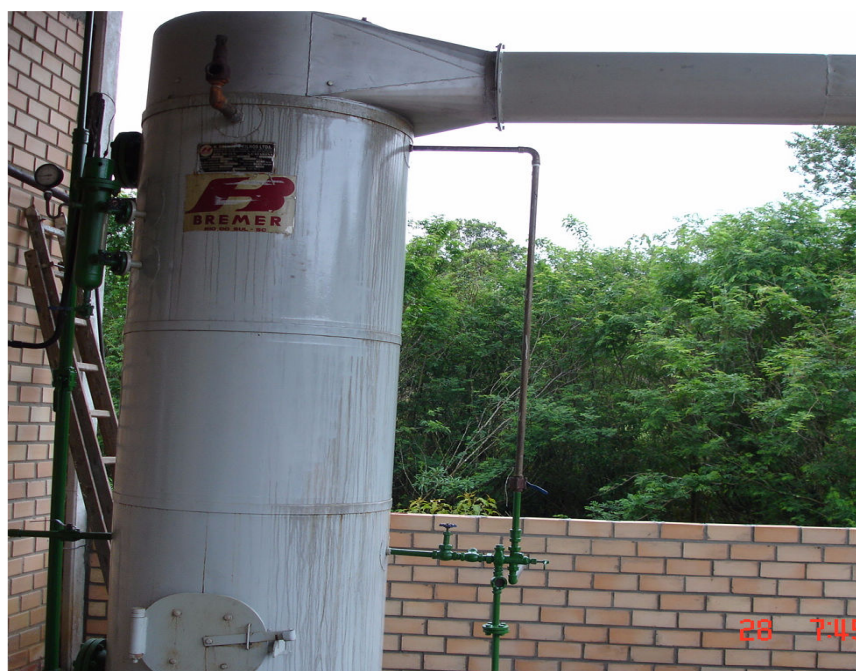
Figura 5.2: Caldeira à lenha para o fornecimento do vapor.
