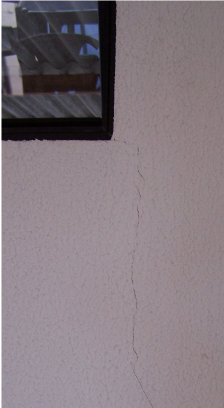
Foto 12 – Fissura diagonal em alvenaria. Salão de festas do edf. Ville de Montpellier. Foto do autor (2006)
