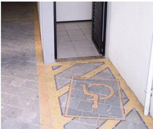
Foto 19 - Passagem inadequada para deficientes. Foto do autor (2006)
