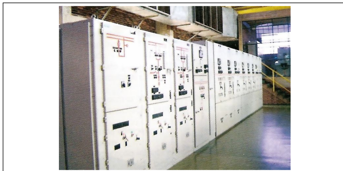
Figura 20: Sistemas de distribuição de energia da Jalles.
