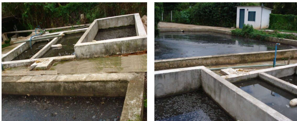
Figura 4 – Vista geral do sistema de filtragem da água residuária de suinocultura.
