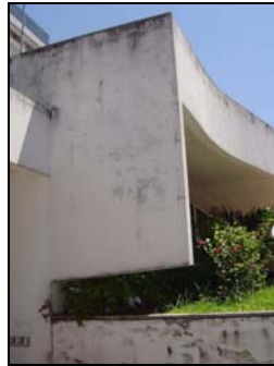
Foto 2 - Protetor vertical. Fachada Leste.
