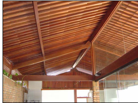
Foto 69: Casa C.3 – Telha cerâmica sobre madeiramento. Passagem de ventilação entre a cobertura e as paredes externas nas 4 fachadas.
