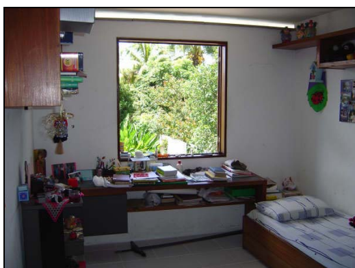
Foto 146: Casa U1.7 – Parede externa dos quartos solta do teto. Pavimento superior.
