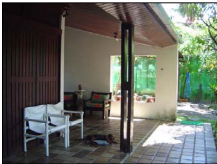
Foto 52: Casa U2.9 – Calha de Zinco. Parcial Fachada Norte.
