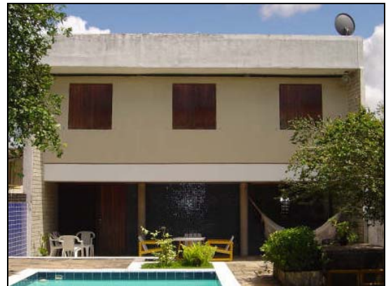
Foto 71: Casa U1.7 – Telha de fibrocimento rodeada com platibanda. Parede solta da laje. Fachada Sudeste.
