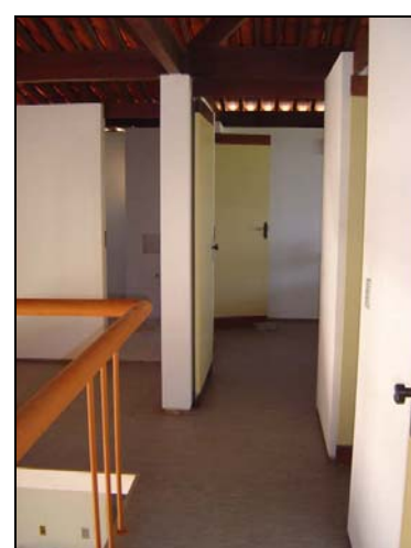
Foto 163: Casa P.9 – Paredes soltas do teto.
