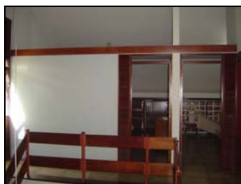
Foto 9 - Quartos. Paredes soltas do teto.
