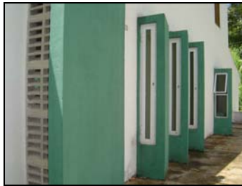
Foto 04 – Protetores na Fachada Oeste.
