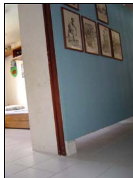
Foto 10 - Quartos. Divisória interna solta do piso.
