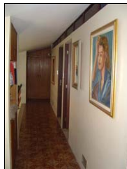
Foto 8 - Circulação dos quartos. Divisória solta da laje.
