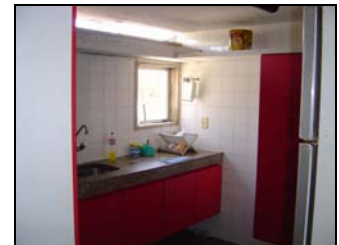
Foto 08 - Cozinha. Parede externa solta da laje.
