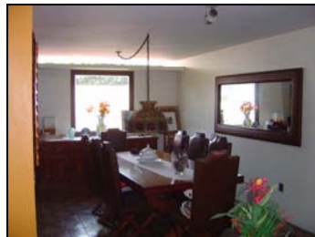
Foto 5 - Jantar. Parede externa solta da laje.
