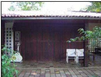
Foto 2 - Esquadria vazada de madeira. Orientação Leste.
