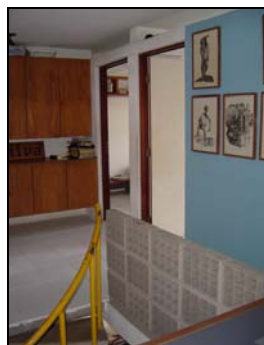
Foto 09 - Quartos. Divisória interna solta da laje.
