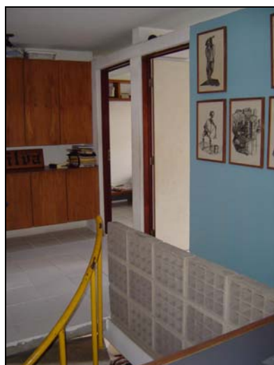
Foto 148: Casa U1.7 – Divisória entre os quartos e circulação solta do teto e do piso. Pavimento superior.
