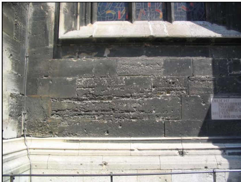
FIGURA 10. Alteração diferenciada ao longo do muro devido à intercalação de lâminas de argilito (depressões de relevo) com camadas finas de arenito. Fonte: Angeli, 2007.
