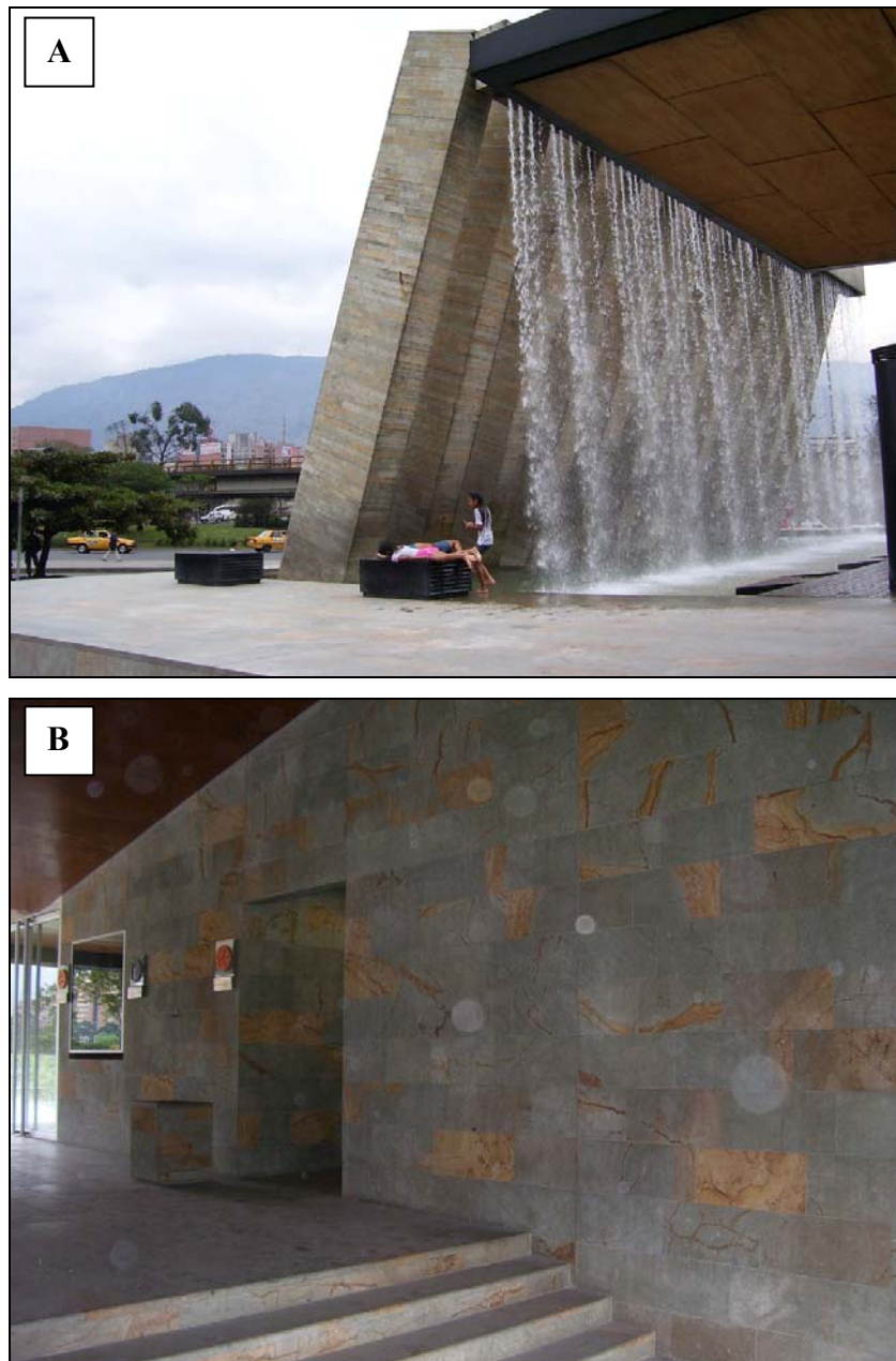
FIGURA 13. Uso do mesmo tipo de calcário em locais diferentes, gerando-se processos diferenciados de degradação, intenso por exposição permanente à corrente de água (A) e insignificante quando usado em muros internos (B).
