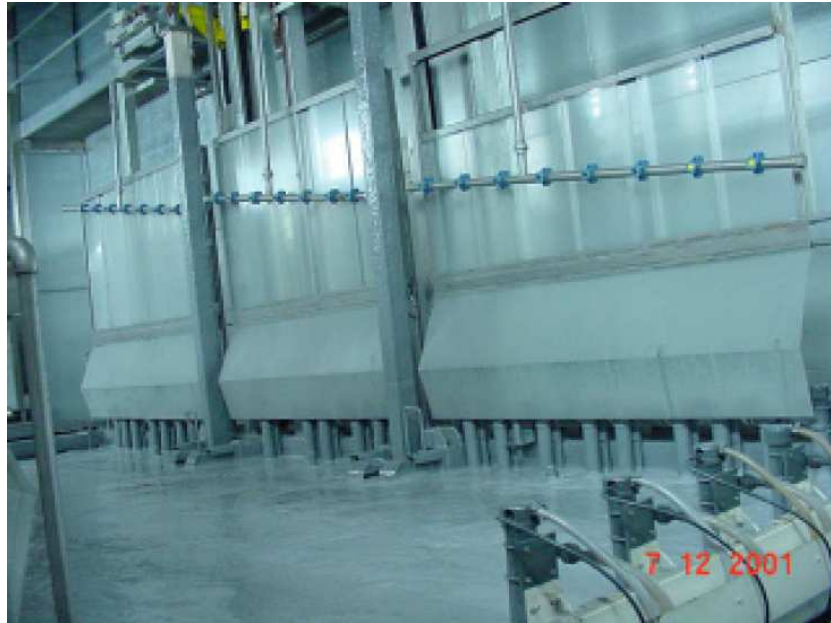
Figura 11 – Ânodos de borda do tanque - CVP
