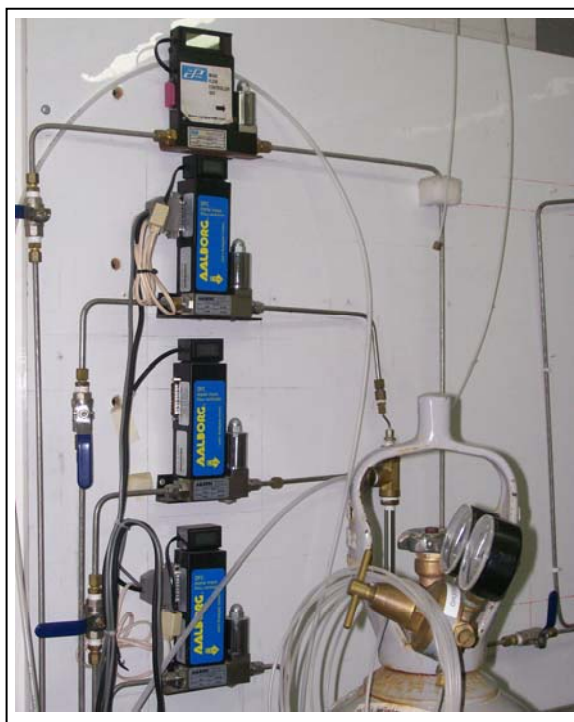
Figura 3.4 - Válvulas controladoras de vazão
