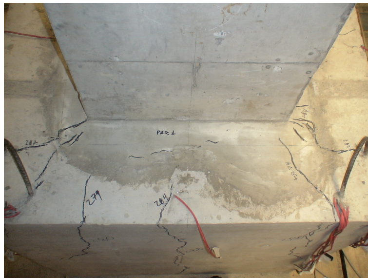
Figura 4.9: Estado de fissuração da parede transversal 1 - Modelo IL5
