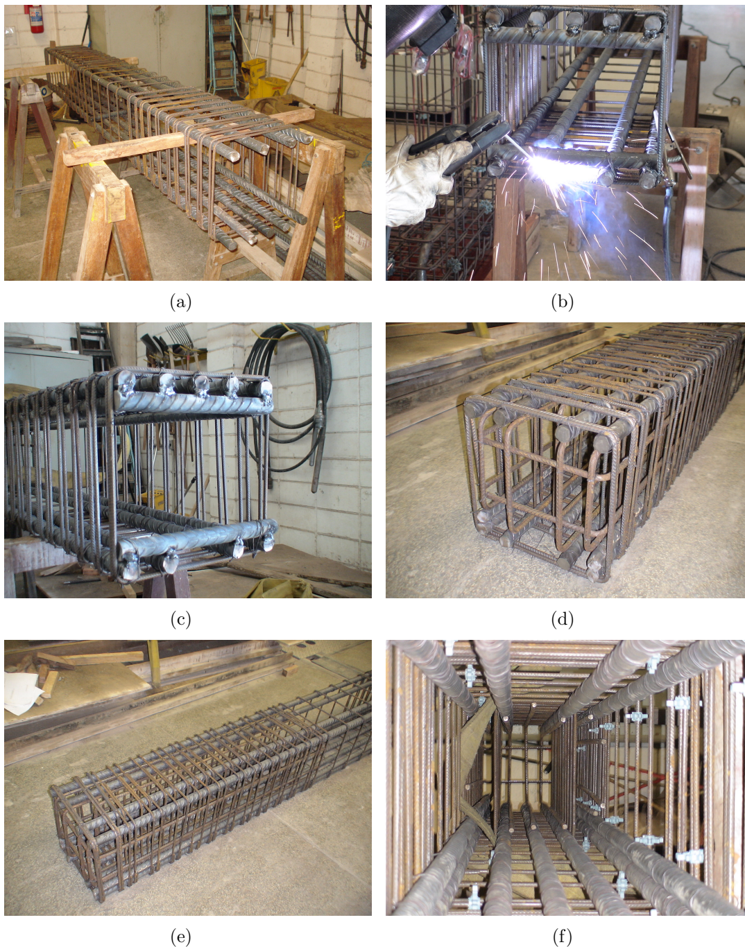
Figura 3.21: Montagem das armaduras do protótipo IR4: (a) Posicionamento das armaduras; (b) Aplicação da solda nas barras transversais; (c) Solda finalizada; (d) Detalhe da face de topo do pilar; (e) Trecho superior do lance de pilar; (f) Detalhe interno;
