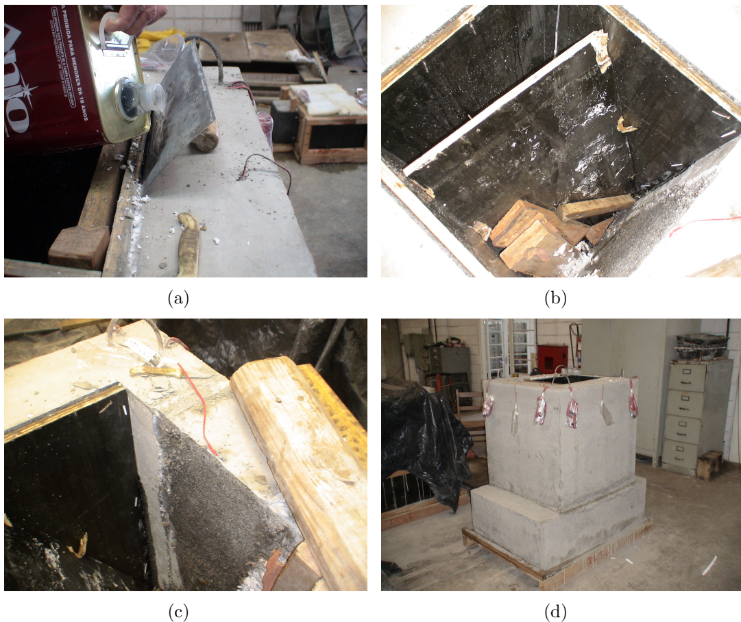
Figura 3.24: Retirada das fôrmas dos cálices: (a)Aplicação do solvente; (b) Retirada da parte interna da fôrma ; (c) Aspecto da parte interna do cálice; (d) Cálice pronto;
