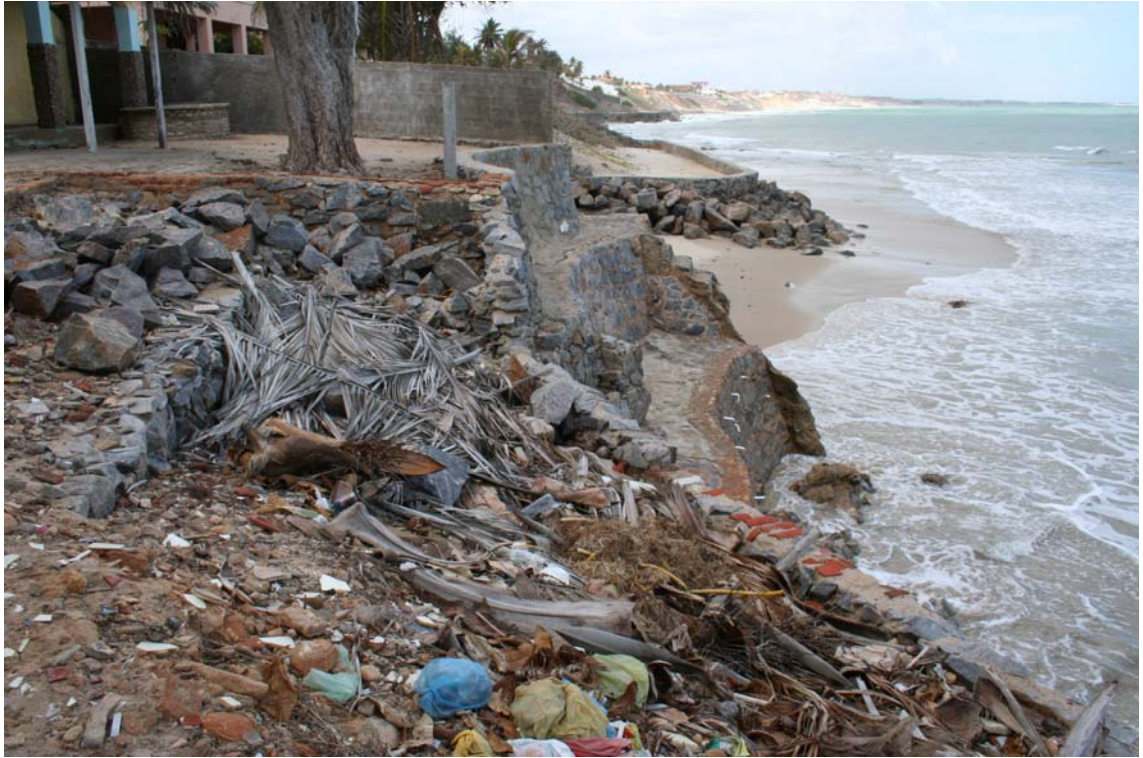
Figura 48 – Efeitos da erosão costeira sobre a estética no litoral da praia do Pacheco.
