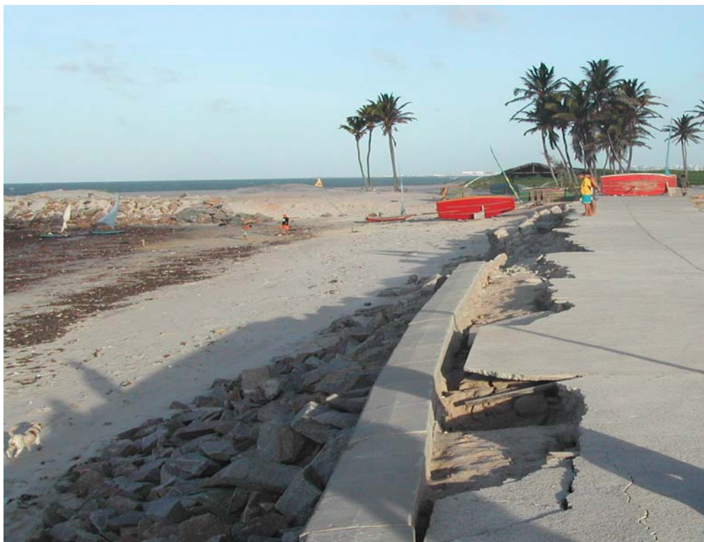
Figura 42 – Destruição do calçadão da avenida Presidente Castelo Branco em decorrência da ação das ondas de ressaca.
