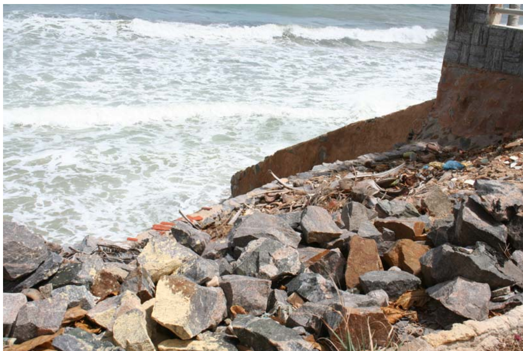
Figura 47 – Desaparecimento da praia em decorrência da ação da erosão costeira.
