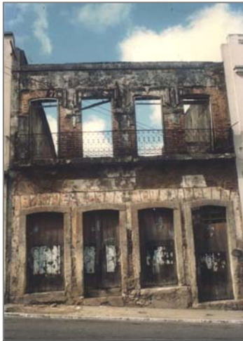
FIGURA 4.8 – Imóvel em estado de ruína, na Avenida João Suassuna, em meados da década de 1990.
