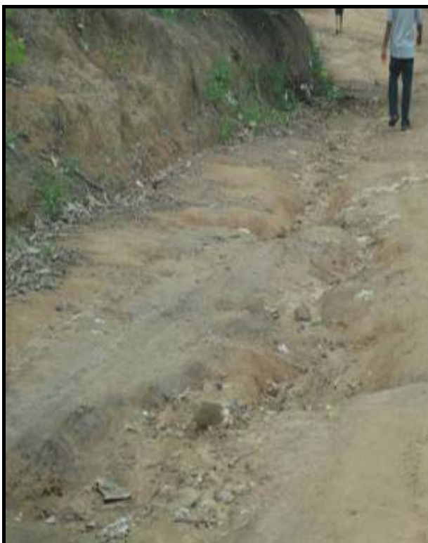
Figura B. 15 – Rua com grandes deformações (Engenho Velho)
